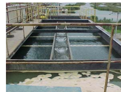
Tanques de floculação e decantação da água
